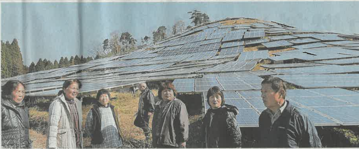
太陽光パネルが一面を埋める共有原野。荒木和久さん(右)ら水増集落の住民たちで設置を決めた。熊本県山都町
